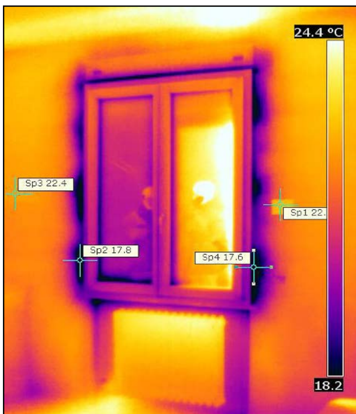
Fig. 2 - Indagine termografica su una finestra. La termocamera fotografa i punti deboli attraverso i quali vi è dispersione di calore. Le aree scure (le più fredde), si collocano al perimetro dell'infisso, il che significa che il sistema di installazione risulta un punto debole. Si aggiungono il non perfetto isolamento del giunto ed il controtelaio metallico. Tratta da ifarinelli.com
