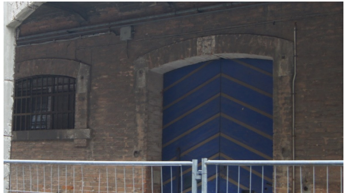
"Codice dei Magazzini" sopra gli accessi
