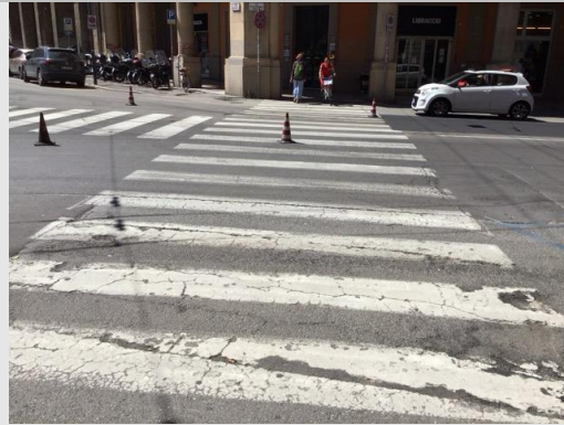
Via Don Giovanni Minzoni – doppio attraversamento pedonale in mezzo alla carreggiata, privo di segnaletica podotattile di orientamento al centro dello stesso (lungo più di 10 m) e di isola di traffico
