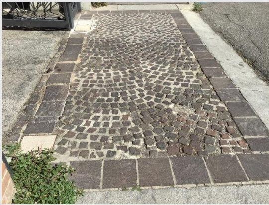
Via dello Scalo – passo carraio con superficie in cubetti di porfido deformata, fughe di dimensioni eccessive e non complanari alla pavimentazione
