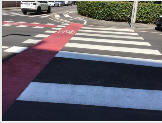
Via della Pietra – attraversamento pedonale su pista ciclabile e carreggiata privo di segnaletica podotattile
