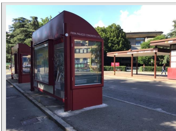
Via del Lavoro – piattaforme delle fermate del TPL con altezza insufficiente
