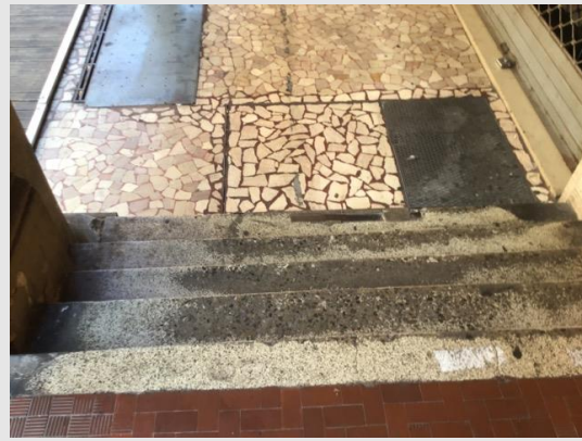
Via Oberdan – porticato con gradini privi di segnaletica podotattile di orientamento e differenziazione cromatica sui gradini
