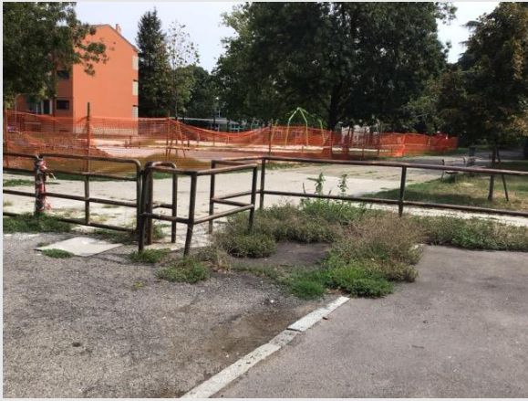
Via Legnano – elementi dissuasori d'ingresso privi di spazio utile di passaggio e sconnessioni nella pavimentazione
