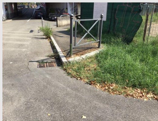
Via Cleto Tomba – percorso residenziale interrotto, privo di continuità
