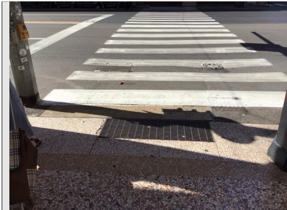
Via Irnerio – segnaletica podotattile di orientamento inadeguata (assenza di intercettazione) e assenza di linea guida al centro dell'attraversamento
