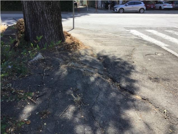
Via delle scuole – Sconnessioni causate dalla presenza di radici affioranti
