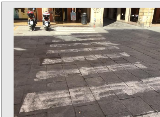
Via Oberdan – Attraversamento pedonale degradato, privo di raccordi adeguati e di segnaletica podotattile di orientamento
