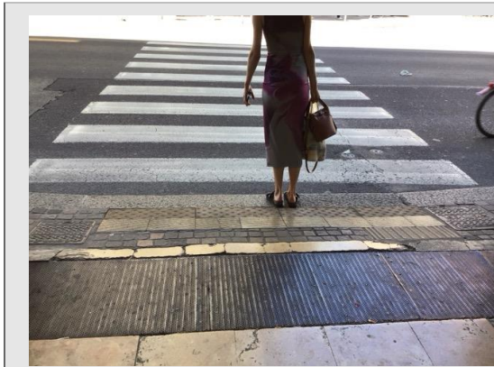
Via Guglielmo Marconi – Attraversamento pedonale dotato solo di segnaletica di "pericolo valicabile", privo di intercettazione
