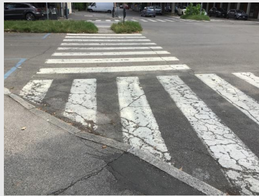
Viale Zagabria – attraversamento pedonale privo di segnaletica podotattile di orientamento e posto su un marciapiede con forma inadeguata
