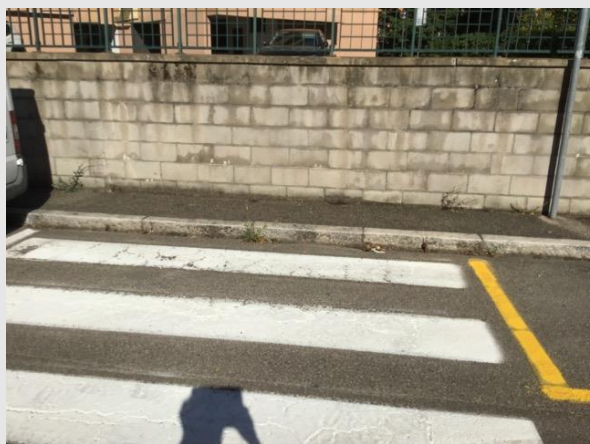
Via Gino Cervi – Attraversamento pedonale privo di raccordi adeguati
