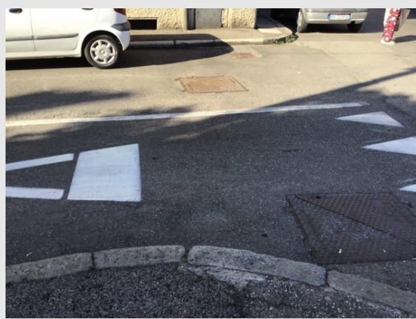
Via Speranza – assenza di attraversamento pedonale
