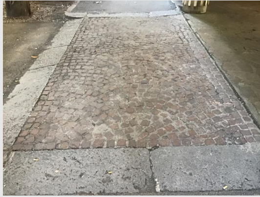
Via Domenico Zampieri – passo carraio in cubetti di porfido con sconnessioni / fugature inadeguate
