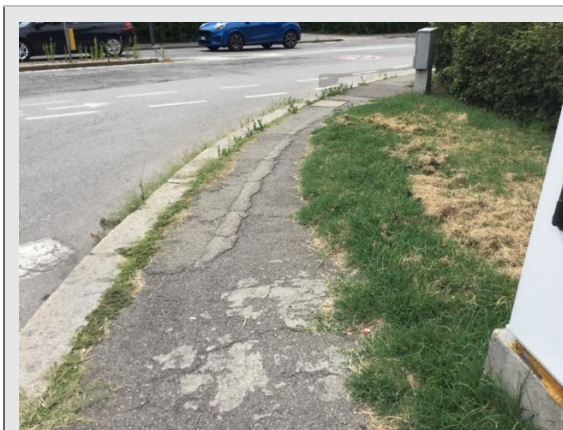
Via Amedeo Lipparini – vegetazione che occupa parte del percorso pedonale e causa sconnessioni
