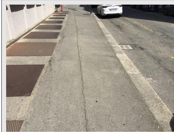
Via Nino Nannetti – sede variabile del percorso pedonale con cedimenti
