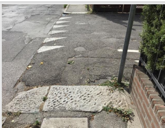
Via Colombarola – assenza di attraversamento pedonale segnalato, degrado della pavimentazione
