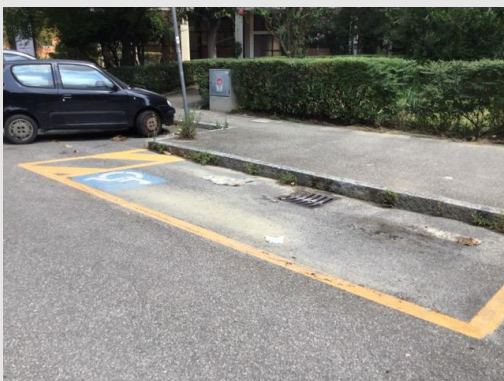
Via Alberto Trauzzi – parcheggio riservato per persone con disabilità in linea privo di raccordo con il percorso pedonale in rilevato
