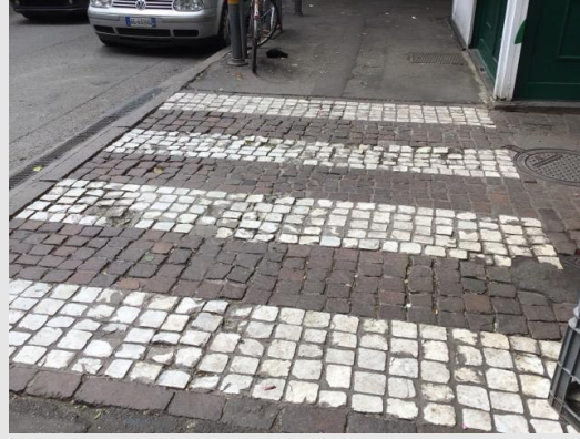
Via Francesco Albani – attraversamento pedonale in cubetti di porfido sconnesso
