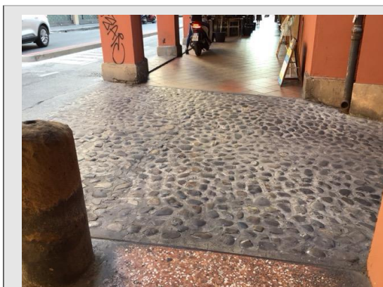
Via San Donato – passo carraio con pavimentazione non omogenea e di difficile percorribilità
