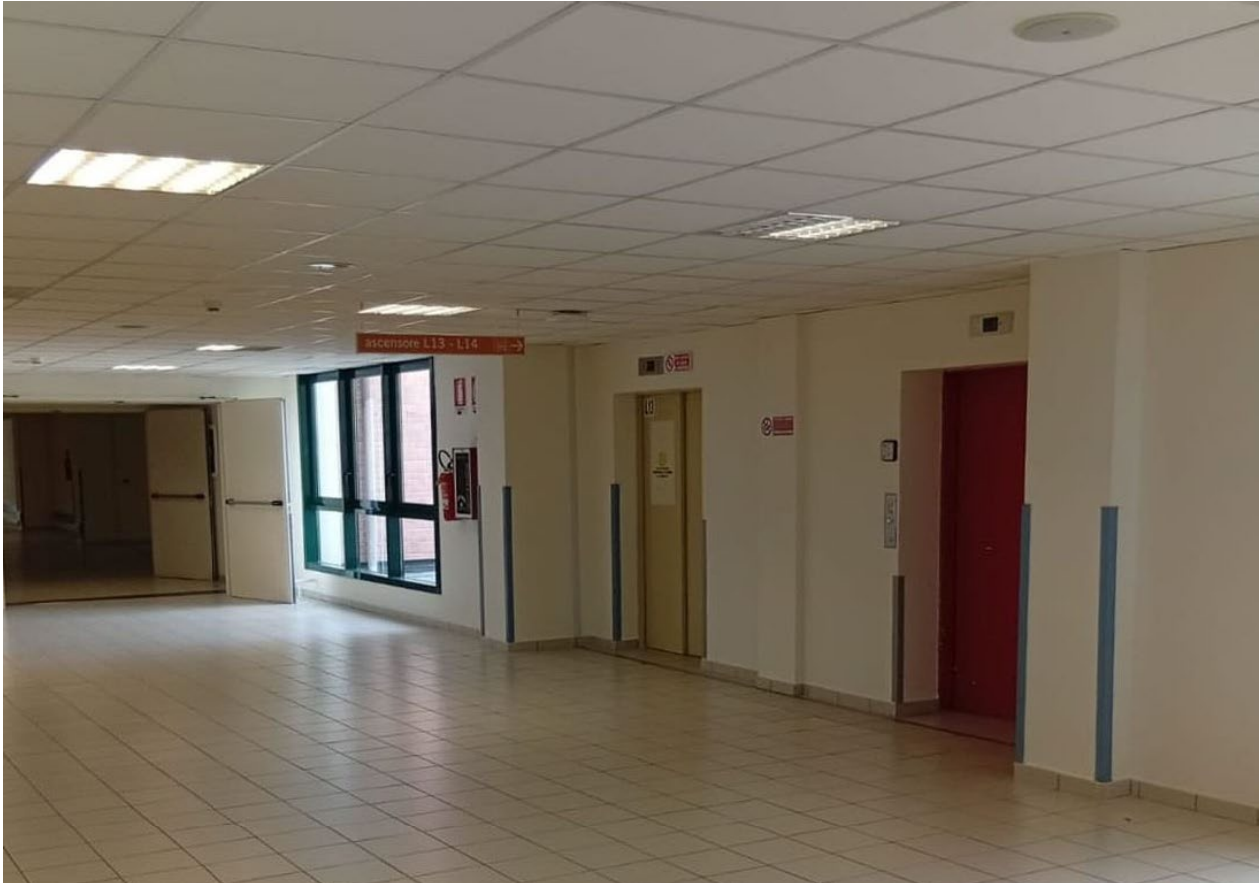
Spazio calmo antistante gli ascensori L13 e L14 (Antincendio) - Piano Primo
